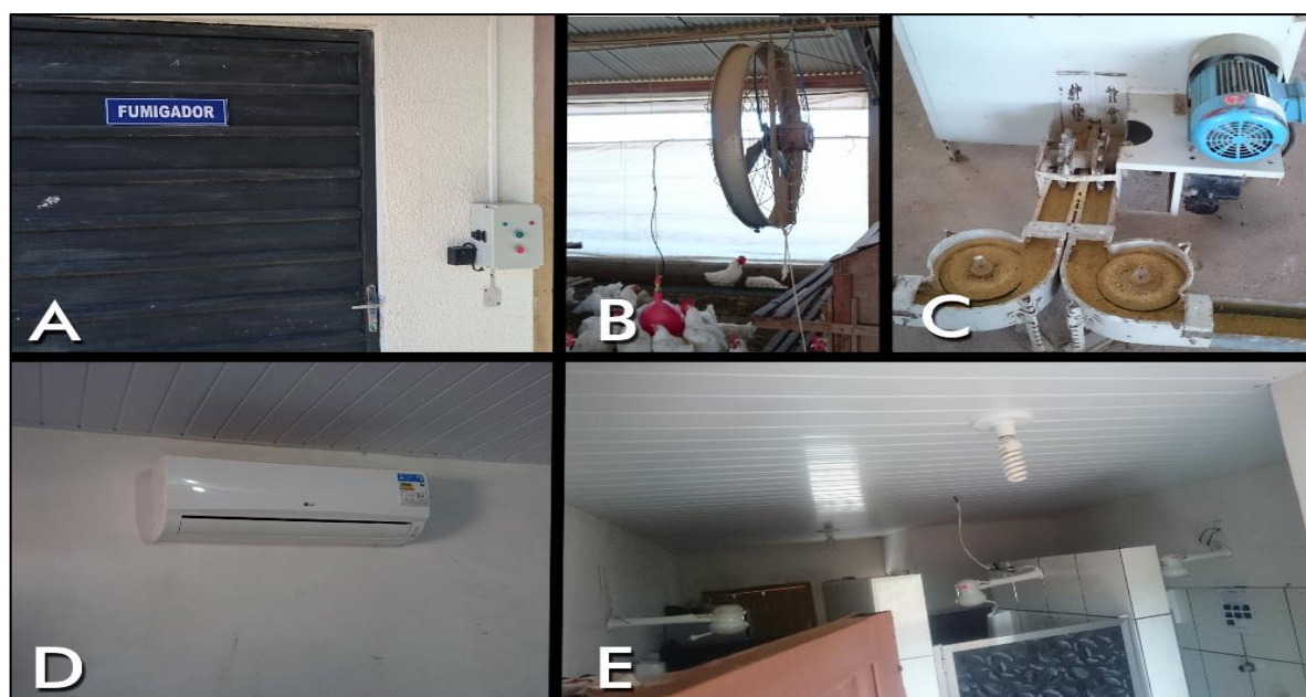
Figura 19 – Exemplo de equipamentos consumidores de energia elétrica
