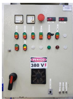
Figura 17. Painel de controle de temperatura da pasteurização
