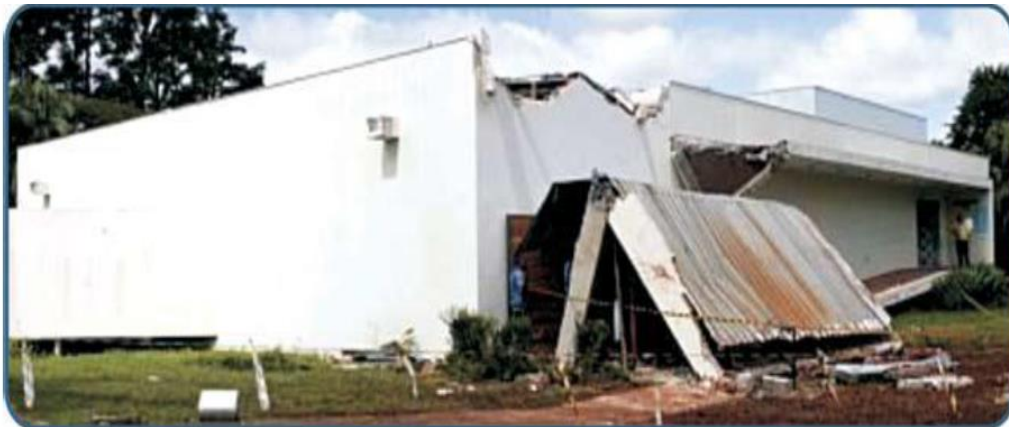
Foto 1: Desabamento de marquise do Anfiteatro da Universidade Estadual de Londrina Fonte: : HELENE, 2008
