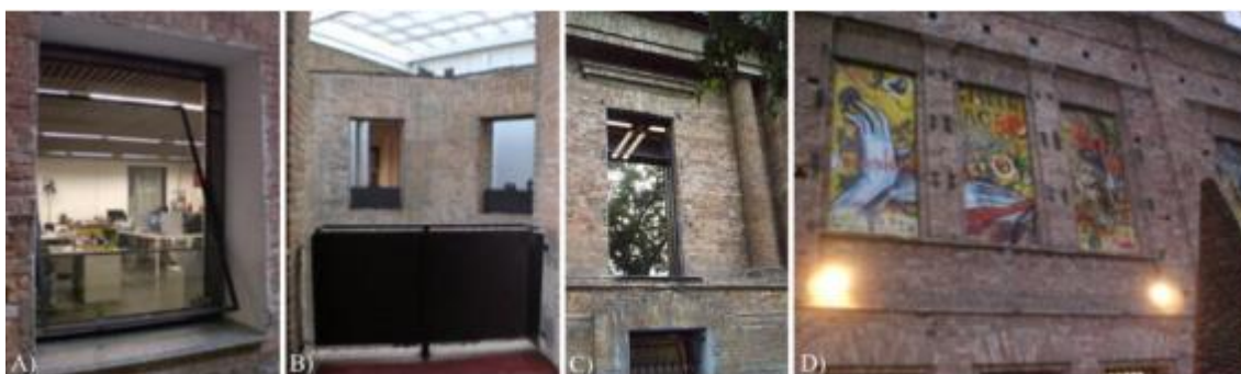
Figura 24 - Detalhes dos substitutos das antigas esquadrias. Fonte: Moraes (2009).
