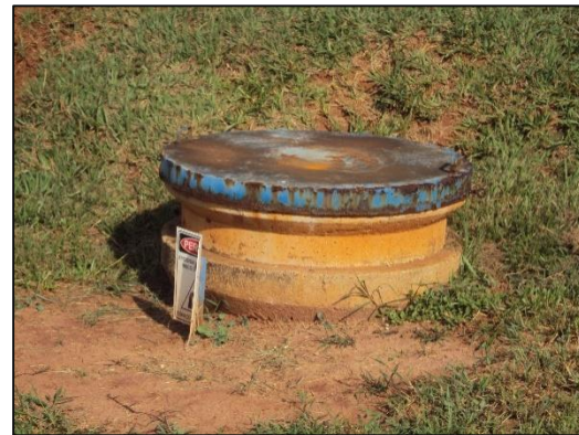
Figura 58 – Caixa de líquido percolado Fonte: Aatoria própria, (2015).
