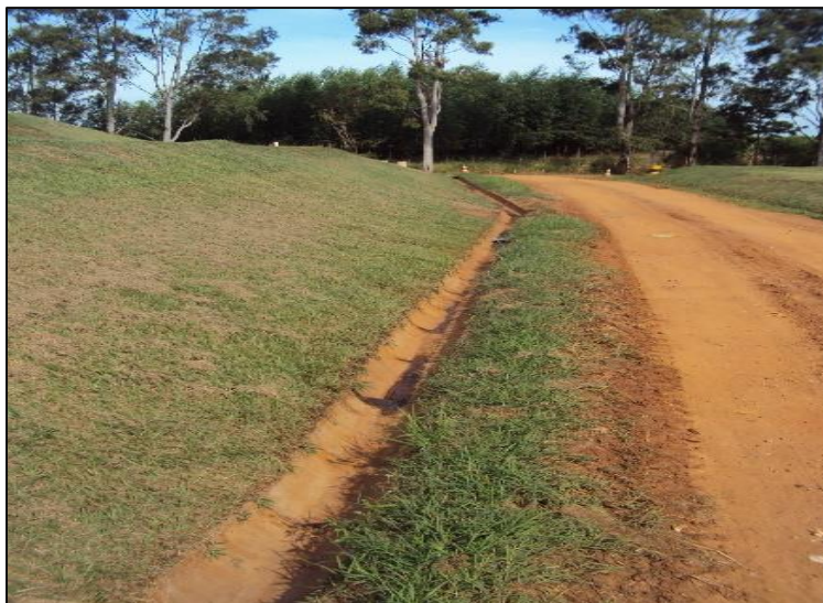
Figura 54– Pequeno afloramento de chorume na canaleta de água pluvial
