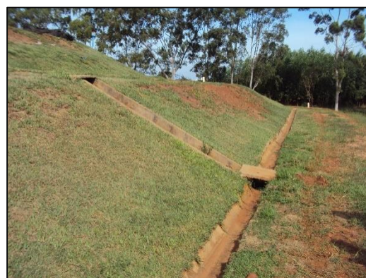
Figura 66 – Canaleta de concreto para coleta de água pluvial Fonte: Autorial própria, (2015)
