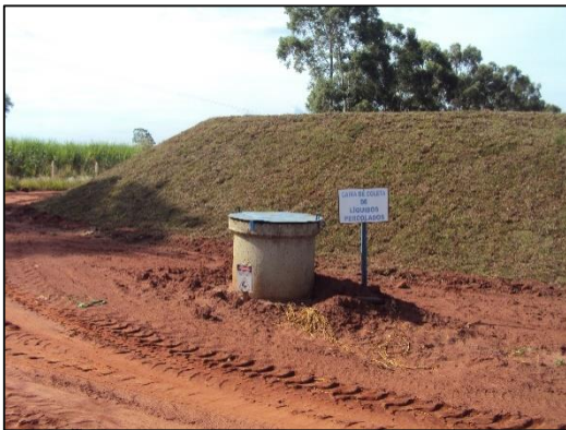
Figura 57 – Caixa de líquido percolado Fonte: Aatoria própria, (2015).
