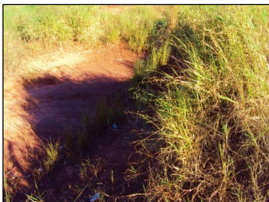
Figura 20 – Vista superior do talude desmoronado. Fonte: Aatoria própria, (2015).
