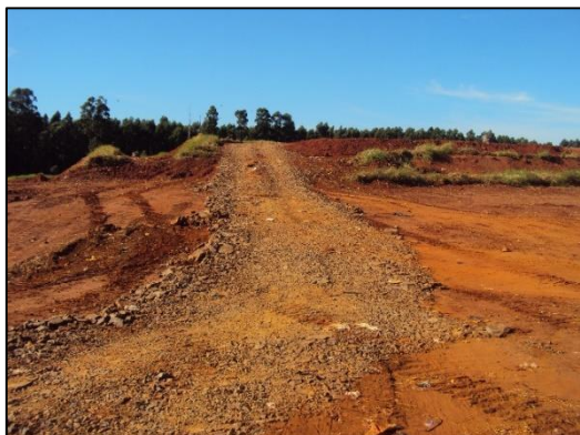
Figura 15 – Acesso à frente de descarga com pavimento revestido com brita. Fonte: Autoria própria, (2015).
