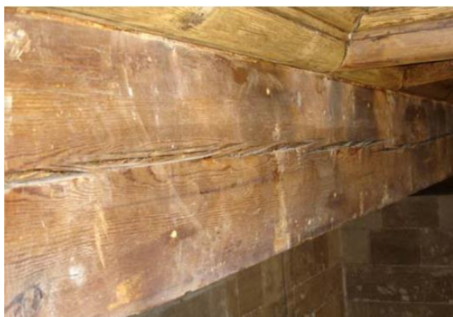
Figura 2 – Exemplo de fenda longitudinal devido a secagem Fonte: Júnior (2006).
