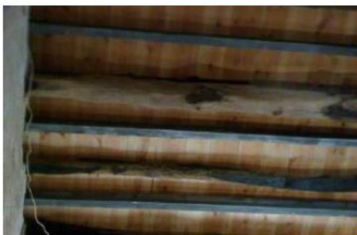
Figura 16 – Perfis metálicos com vigas de madeira existentes no Mosteiro de Tibães, Braga Fonte: Dias (2008 apud COSTA, 2009)
