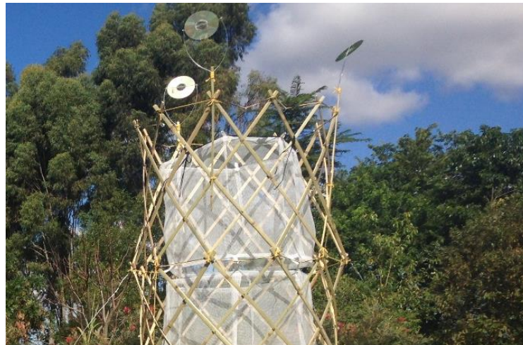
Figura 19 - Dispositivo reflexivo instalado no topo da estrutura Fonte: Autoria própria (2015)
