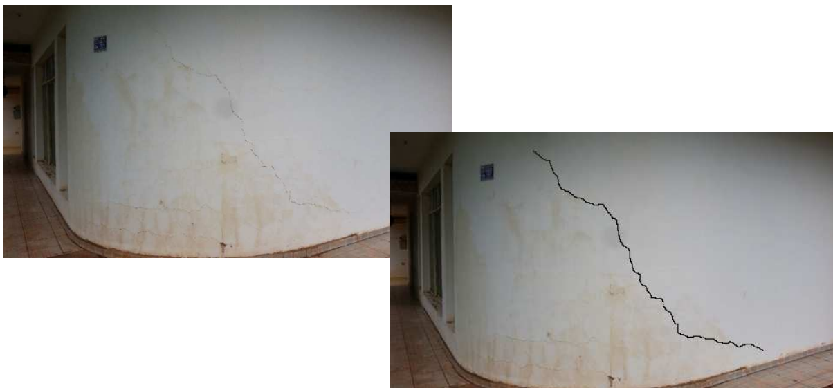
Figura 47 – Fissura transversal devido a recalque diferencial Fonte: O autor (2016)
