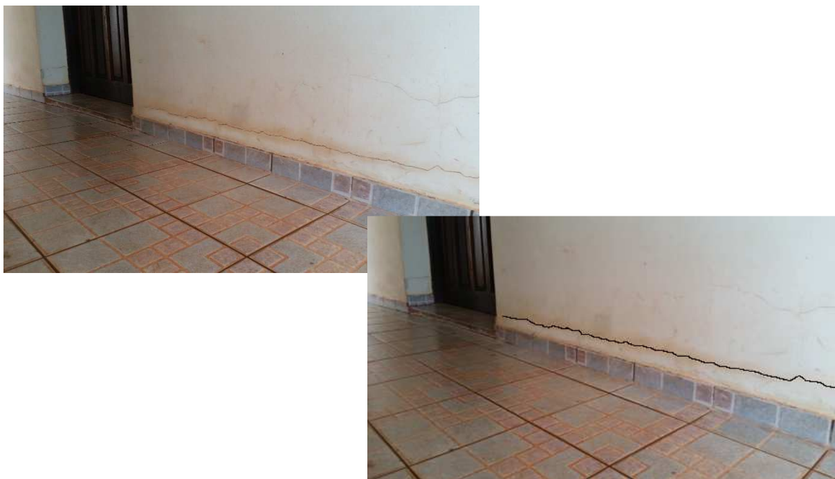
Figura 44 – Fissura causada por movimentação higroscópica na base da alvenaria Fonte: O autor (2016)
