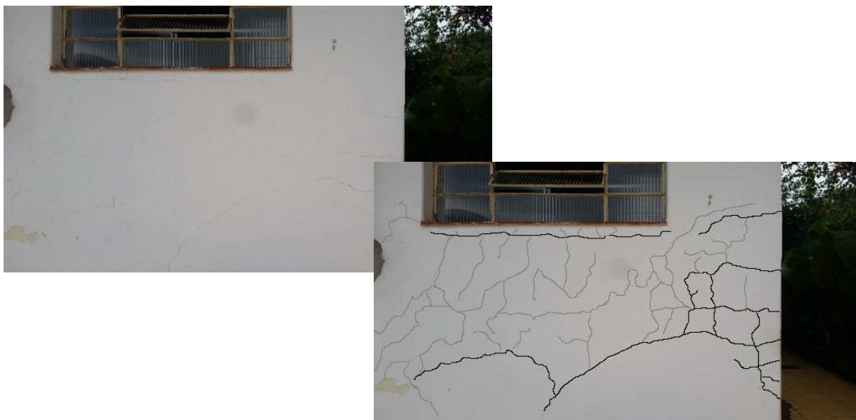
Figura 42 – Fissuras mapeadas de origem térmica Fonte: O autor (2016)
