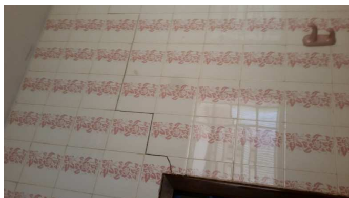
Figura 38 - Fissura observada no canto superior de portas internas Fonte: O autor (2016)
