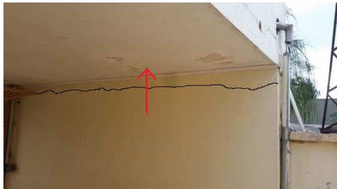
Figura 41 – Mediatriz aponta origem térmica da fissura, entre laje e alvenaria Fonte: O autor (2016)
