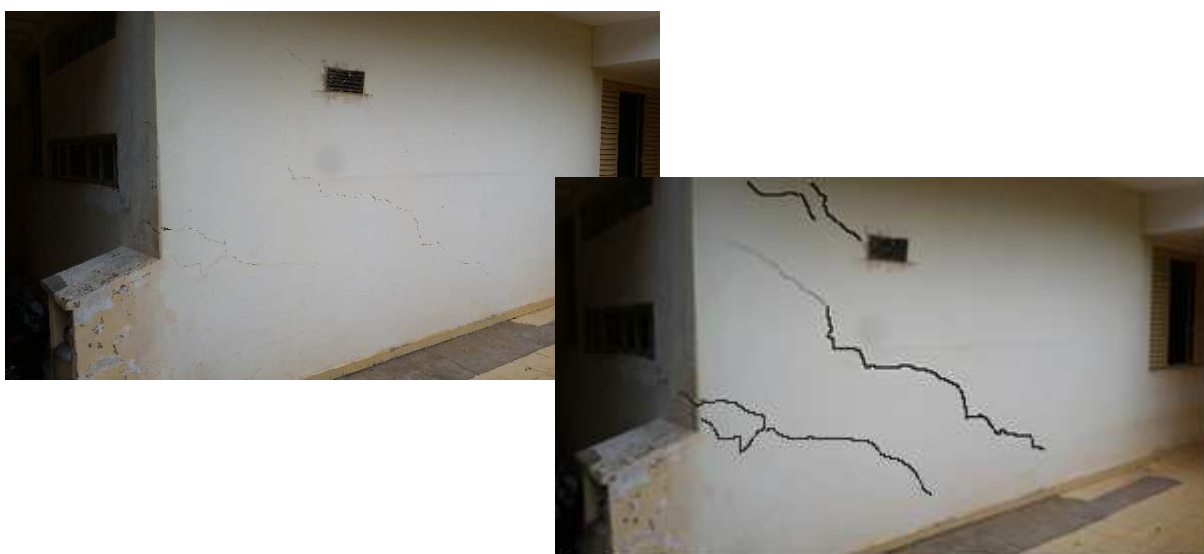
Figura 48 – Fissura transversal devido a recalque diferencial Fonte: O autor (2016)
