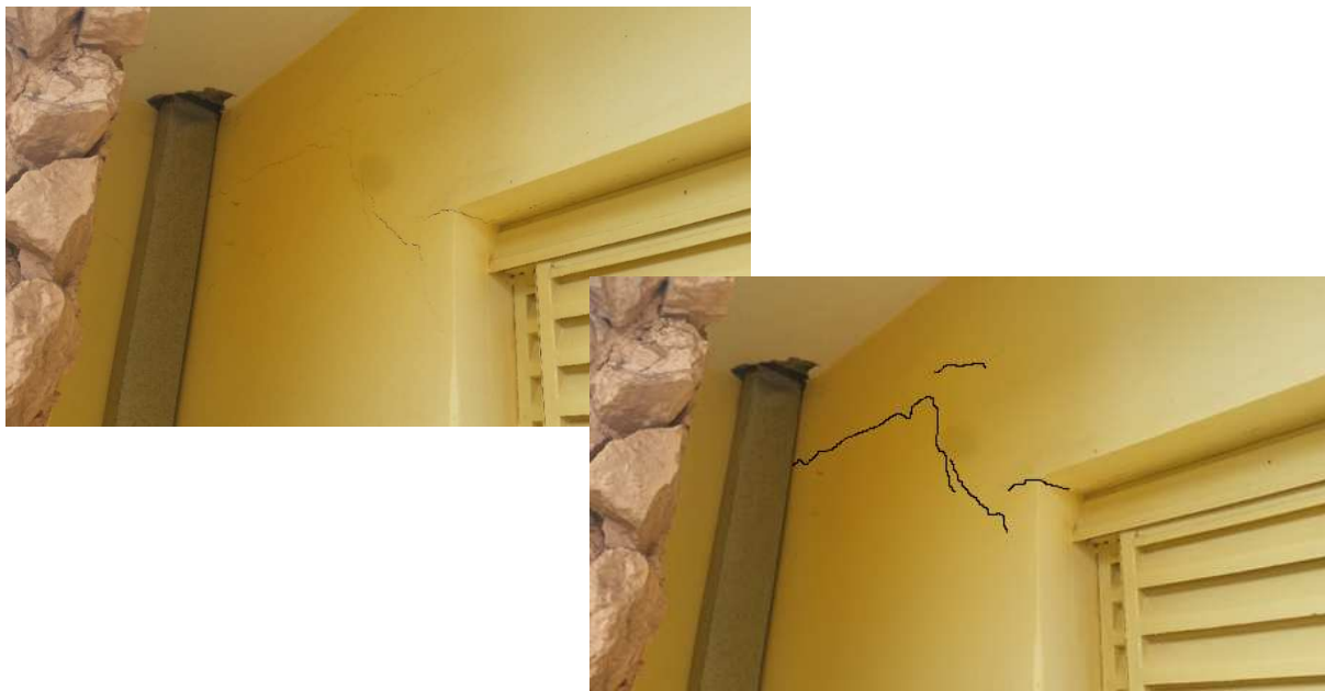
Figura 37 - Fissura observada no vértice superior da abertura da esquadria Fonte: O autor (2016)
