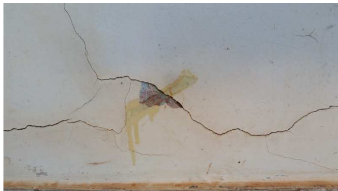
Figura 52 – Verificação de atividade da fissura decorrente de movimentação higroscópica Fonte: O autor (2016)
