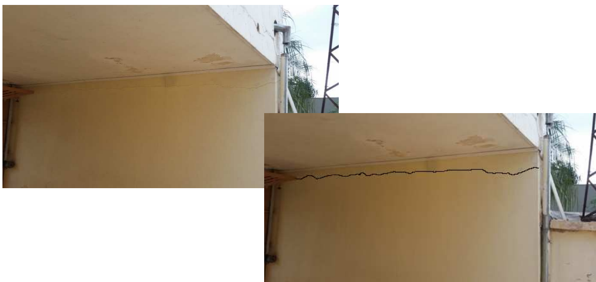
Figura 40 – Fissura entre a laje e a alvenaria Fonte: O autor (2016)
