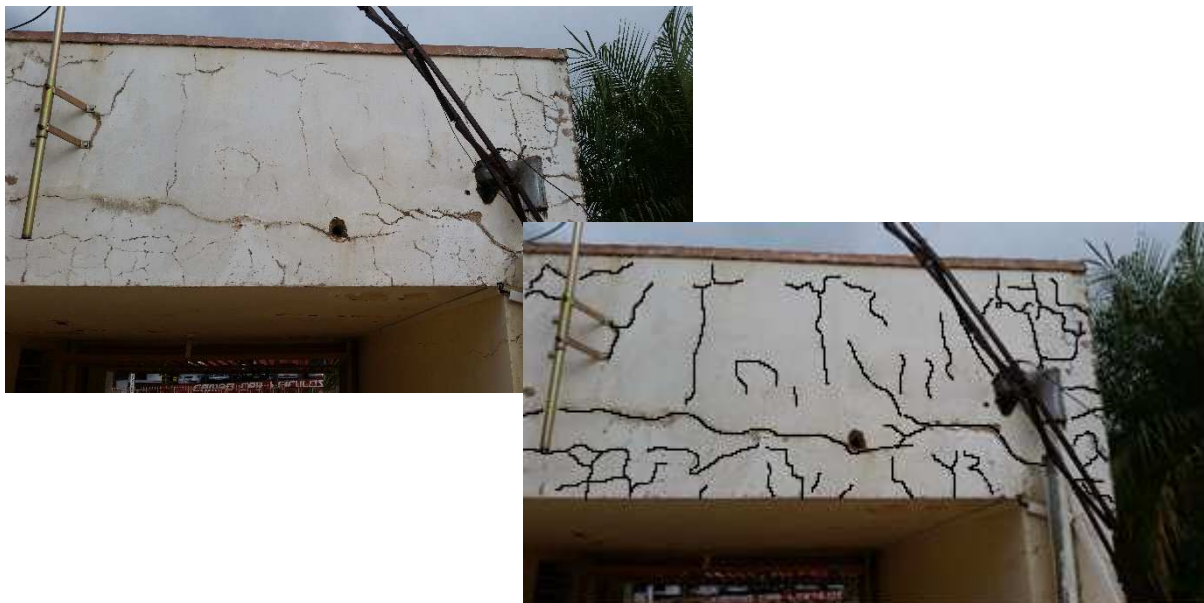
Figura 43 – Fissuras mapeadas de origem térmica Fonte: O autor (2016)
