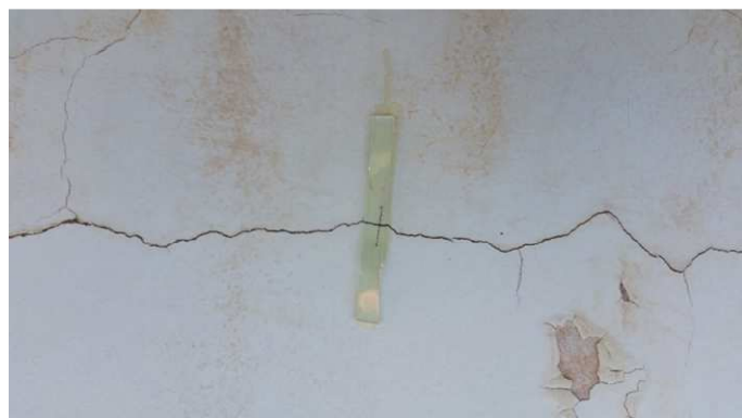
Figura 53 – Verificação de atividade da fissura decorrente de variação térmica Fonte: O autor (2016)
