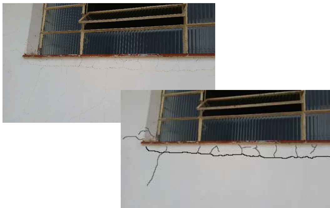
Figura 39 – Fissura horizontal na base da esquadria Fonte: O autor (2016)
