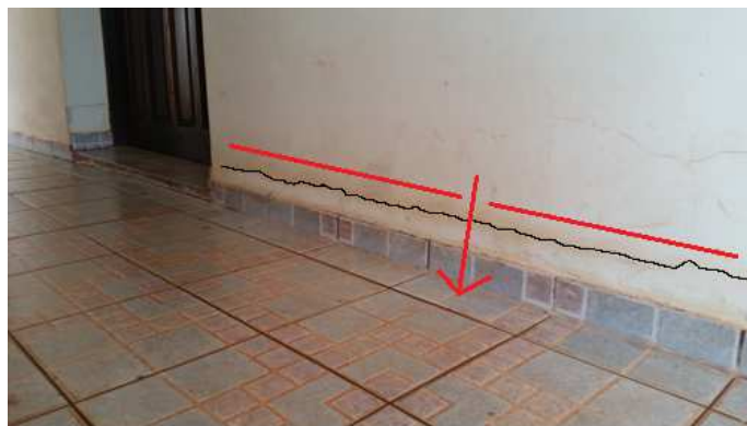
Figura 45 – Mediatriz apontando mecanismo causador da fissura Fonte: O autor (2016)
