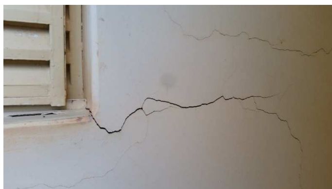
Figura 36 – Fissura observada no canto inferior de janelas Fonte: O autor (2016)
