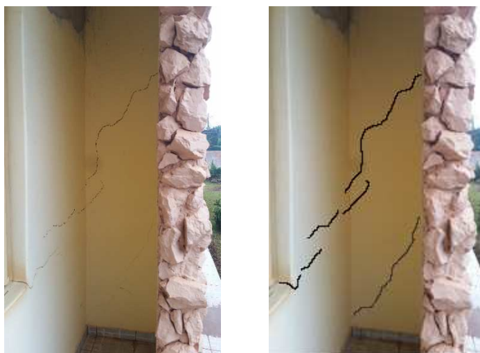
Figura 46 – Fissura transversal devido a recalque diferencial Fonte: O autor (2016)
