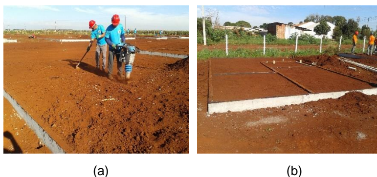
Figura 6 – Preparação da sub-base – (a) início compactação e (b) sub-base compactada. Fonte: do autor (2014).
