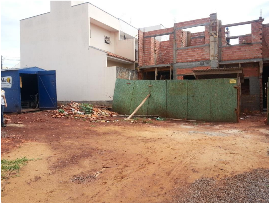
Figura 6 – Armazenamento de resíduos fora do terreno
