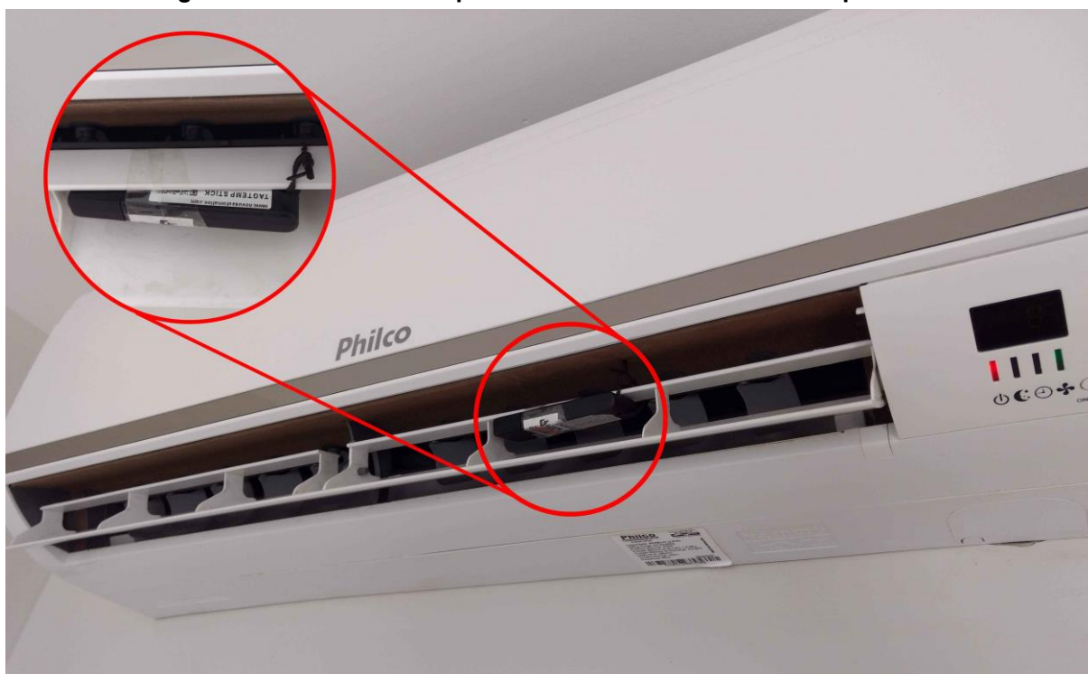
Figura 20 – Sensor de temperatura instalado na aleta da evaporadora
