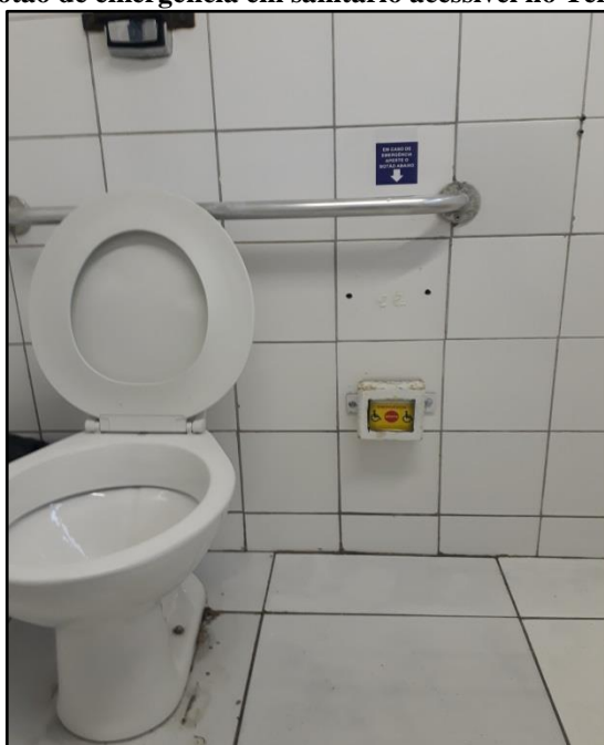
Figura 35: Botão de emergência em sanitário acessível no Terminal Cabral.
