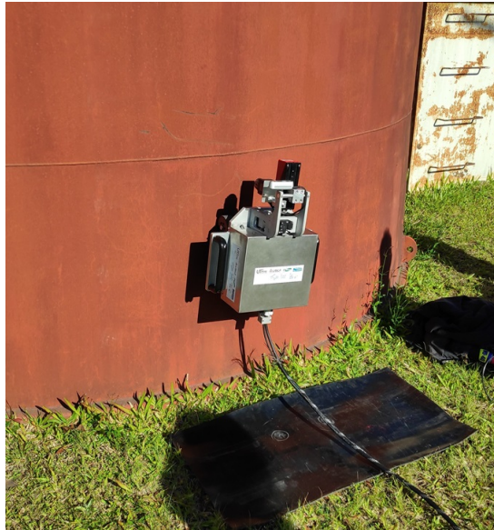
Figura 19 – Robô CRAS recém montado executando testes de adesão e movimentação em um vaso descontinuo.
