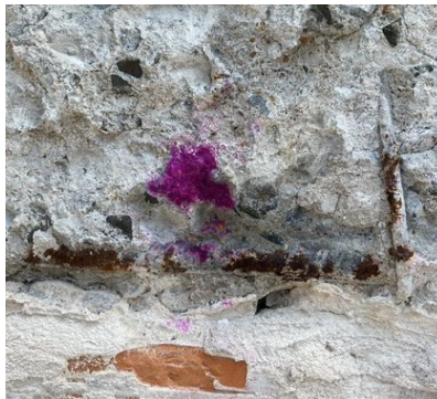
Figura 7 - Ensaio de carbonatação com aplicação de solução de fenolftaleína em viga de concreto armado recém-fraturada
