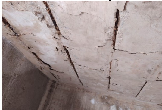
Figura 3 - Corrosão de armadura da laje fundo de caixa d'água
