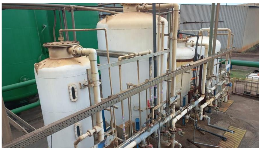
Figura 2 – Sistema de Desmineralização de Água – Unidade Gasa – Linha 2
