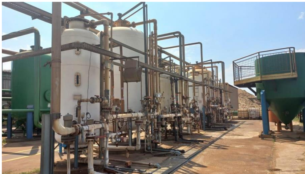
Figura 1 – Sistema de Desmineralização de Água – Unidade Gasa – Linha 1
