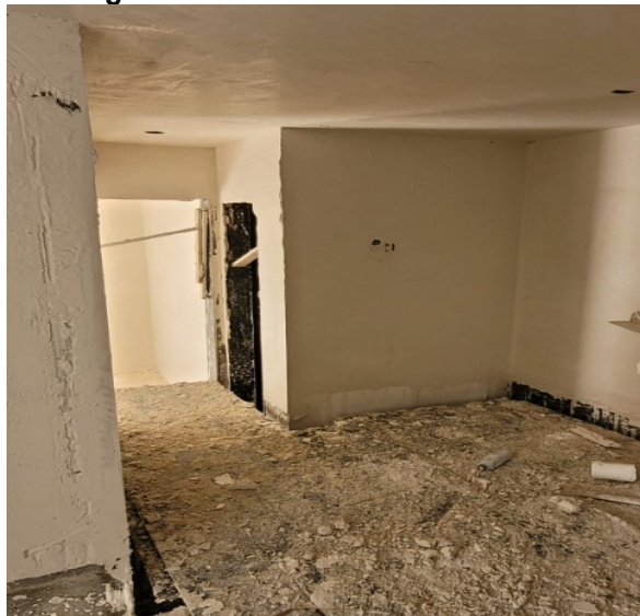
Fotografia 3 – Resíduos sob os andaimes
