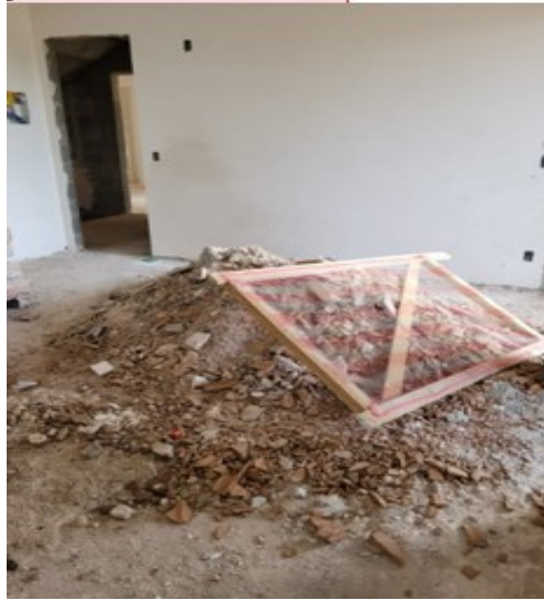
Fotografia 6 – Resíduos de gesso acumulados
