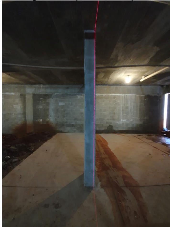
Figura 20 - Desaprumo do eixo do pilar.
