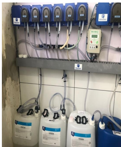
FIGURA 6 - Painel de controle de regulação de produtos químicos para lavagem
