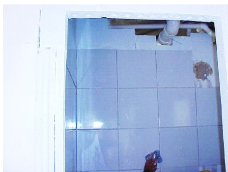
Fotografia 2 - Gesso aplicado em banheiro
