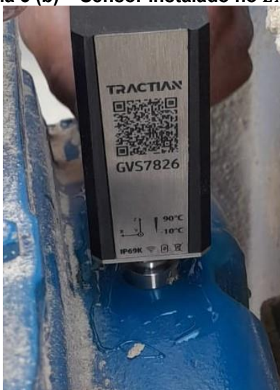
Fotografia 3 (b) – Sensor instalado no EXA – 0019
