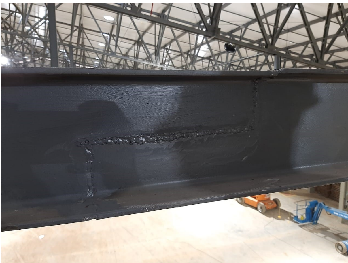
Fotografia 1 - União entre vigas de perfil "w" que compõem o sistema de ancoragem de uma linha de vida rígida horizontal.
