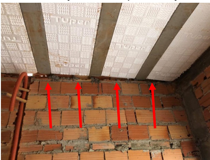
Figura 13 – Lavadeira com laje concretada apoiada em tijolos – Falhas 4.0 e 5.0
