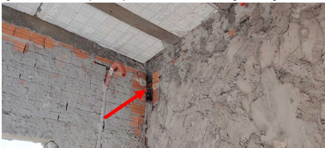
Figura 10 – Armadura exposta no pilar e deficiência na concretagem visão geral - Falha 1.0
