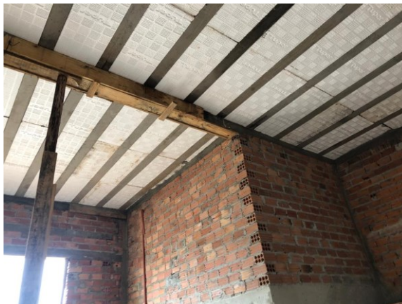
Figura 14 - Viga com vão de 4,22 metros com base de 14 cm e altura 9 cm extremo com verga em L – Falha 6.0
