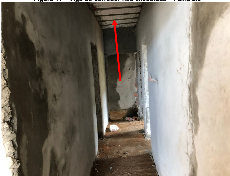
Figura 11 – Viga do corredor não executada – Falha 2.0
