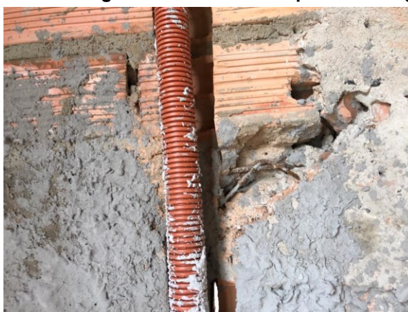
Figura 17 – Falha na concretagem com armadura exposta da verga da janela em “L”
