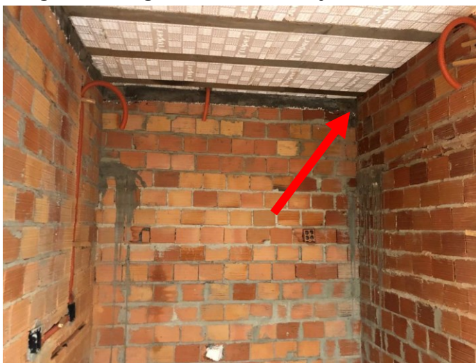
Figura 12 – Viga finalizando nos tijolos – Falha 3.0
