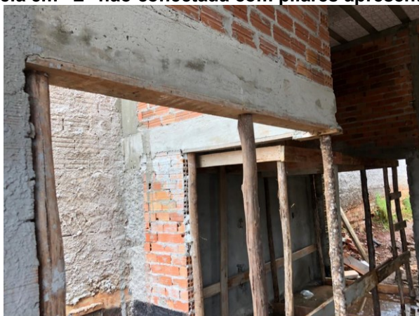
Figura 18 - Verga da janela em “L” não conectada com pilares apresentando trincas – Falha 7.0
