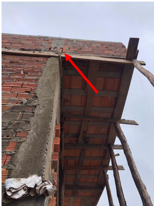
Figura 19 – Pilarete de platibanda exibindo falha na concretagem – Falha 8.0
