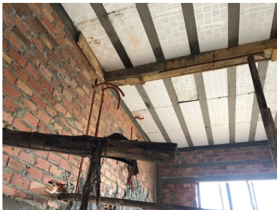
Figura 15 – Viga com vão de 4,22 metros com base de 14 cm e altura 9 cm – Falha 6.0
