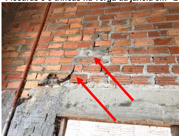
Figura 16 – Fissuras e e trincas na verga da janela em “L”– Falha 7.0
