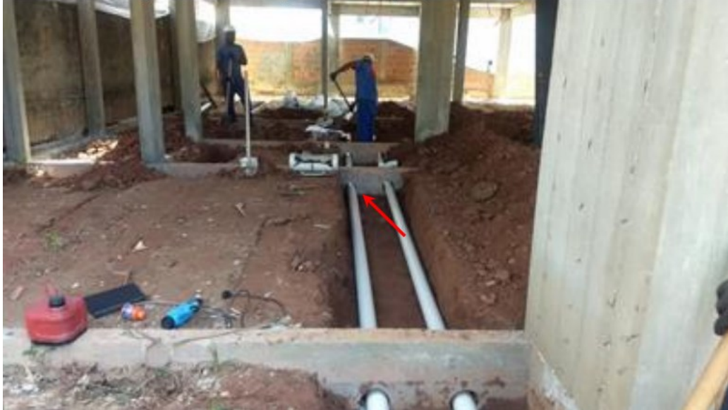
Fotografia 3 – Incompatibilidade entre projeto hidráulico e estrutural
