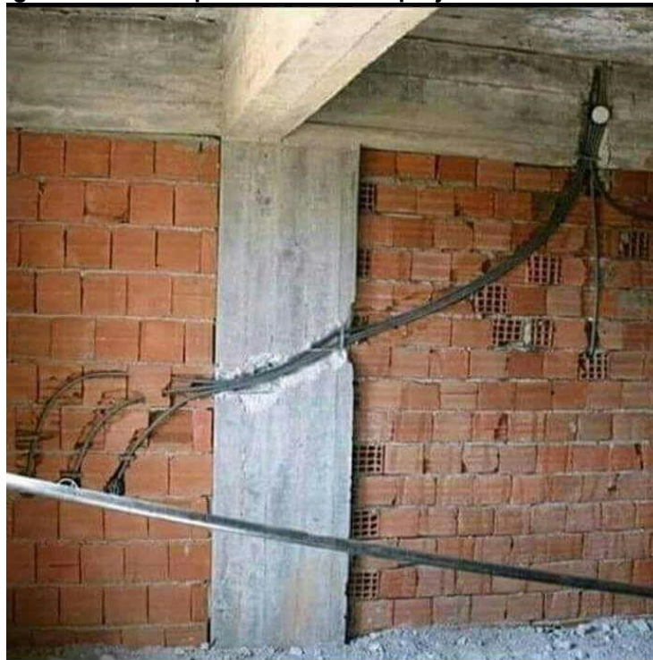
Fotografia 2 – Incompatibilidade entre projeto elétrico e estrutural
