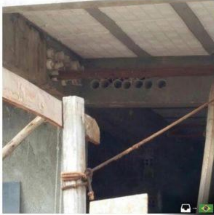
Fotografia 1 – Incompatibilidade entre projeto hidráulico e estrutural
