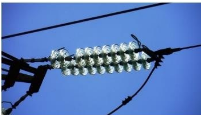
Figura 5: Cadeia de isoladores de vidro.
