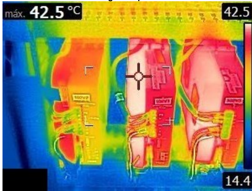
Figura 26 – Resultado de termografia aplicada aos drivers da embaladora
