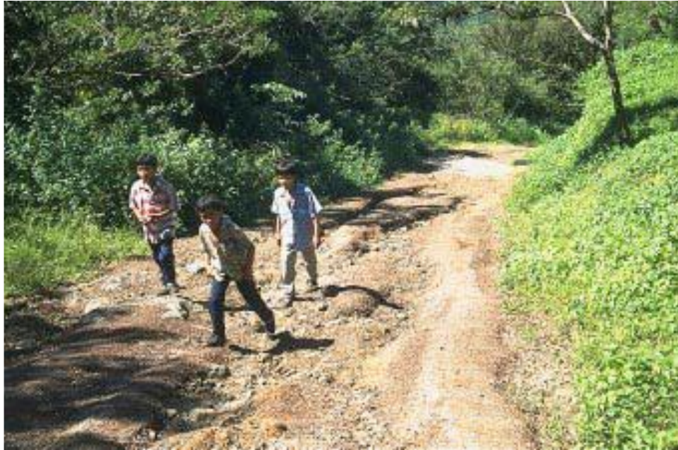
Figura 7: Exemplo de uma estrada com um sistema de drenagem ineficaz. (Keller et al. , 2003).
