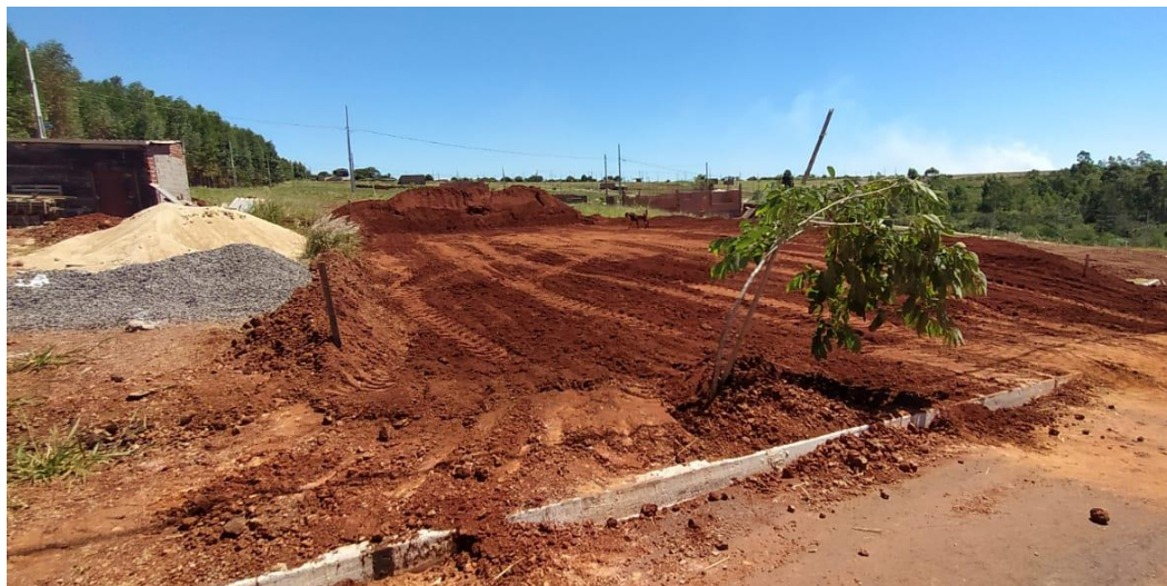
Figura 9 – Areia e brita ao lado do canteiro de uma obra no início.
