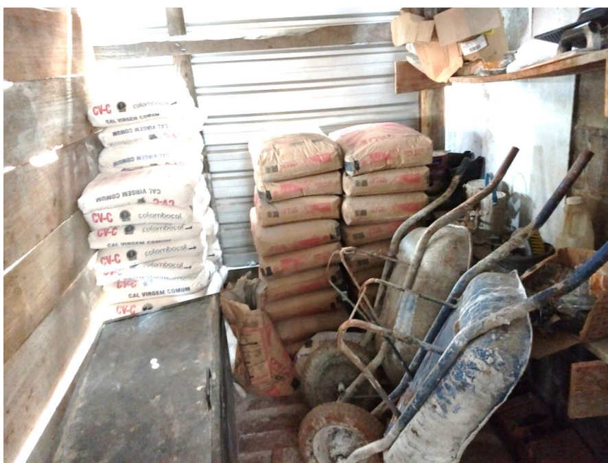
Figura 24 – Sacos de cimento e cal virgem armazenados no abrigo de obra.
