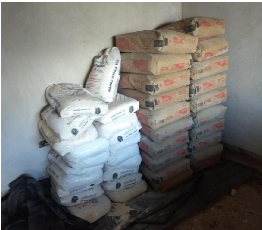
Figura 19 – Sacos de cimento e de cal virgem armazenados no canteiro de obras em local protegido.
