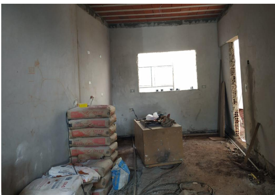
Figura 20 – Sacos de cimento e de cal virgem armazenados no canteiro de obras em local protegido.
