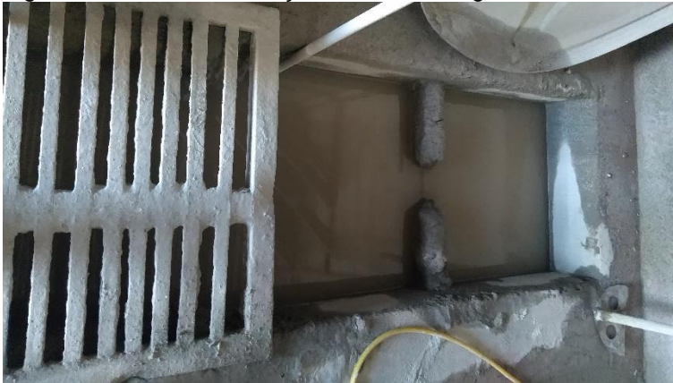
Figura 7: Caixa de decantação dos resíduos gerados
