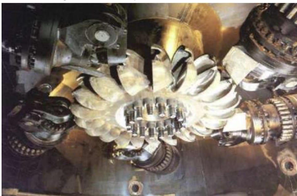
Figura 9 – Turbina tipo Pelton instalada na usina.
