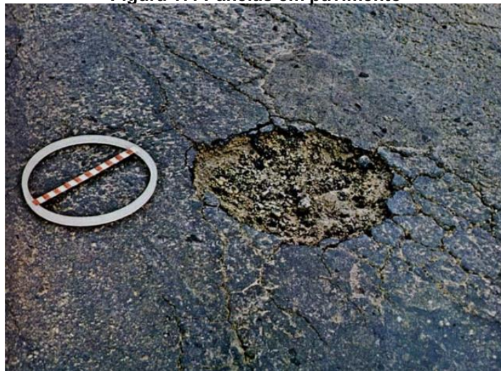
Figura 17: Painelas em pavimento
