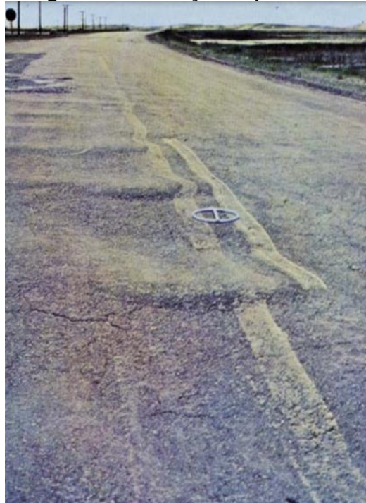
Figura 13: Ondulação de pavimento
