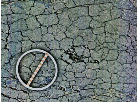
Figura 11: Trincas do tipo couro de crocodilo
