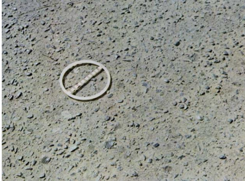
Figura 16: Desgaste de pavimento
