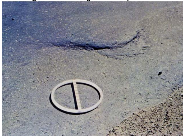
Figura 14: Escorregamento de pavimento
