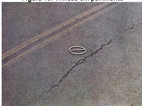
Figura 10: Trincas em pavimento
