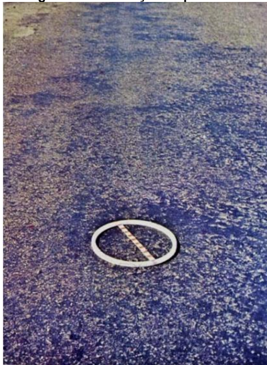
Figura 15: Exsudação de pavimento
