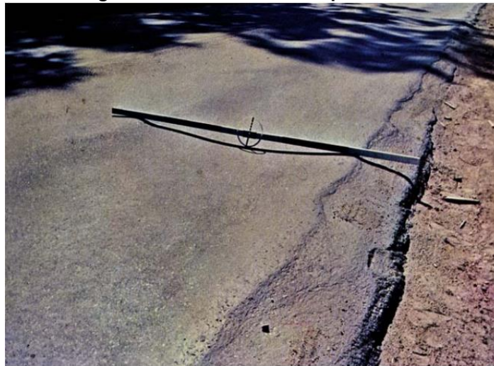
Figura 12: Afundamento de pavimento
