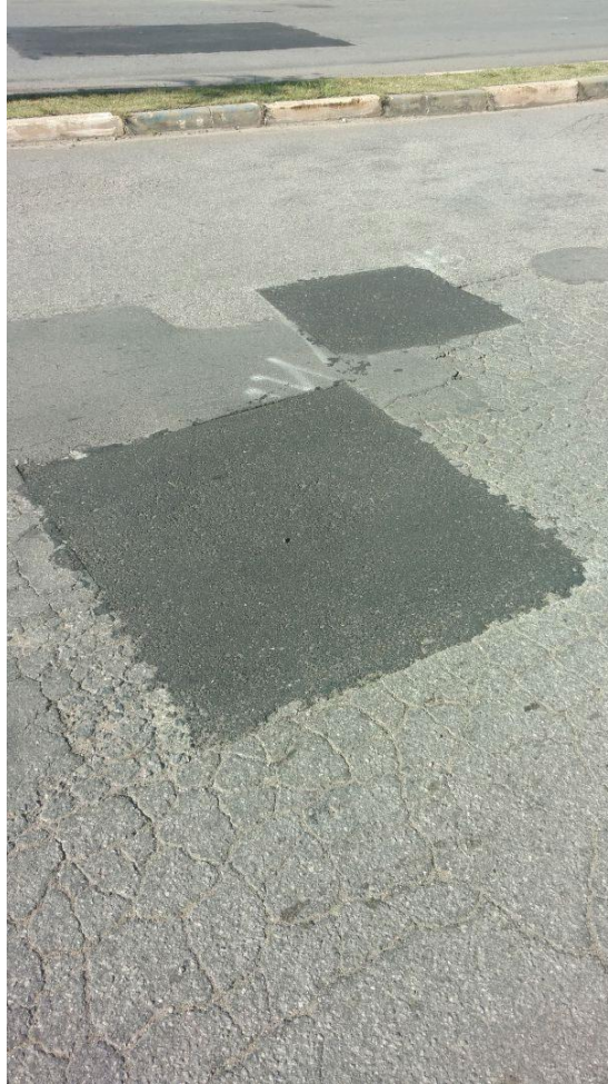
Figura 18: Remendos em pavimento
