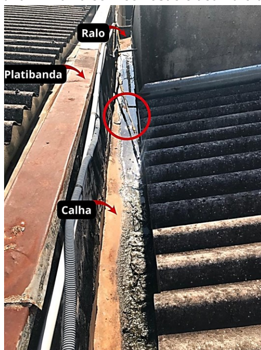
Fotografia 2 - Calha com corrosão e acúmulo de lodo.
