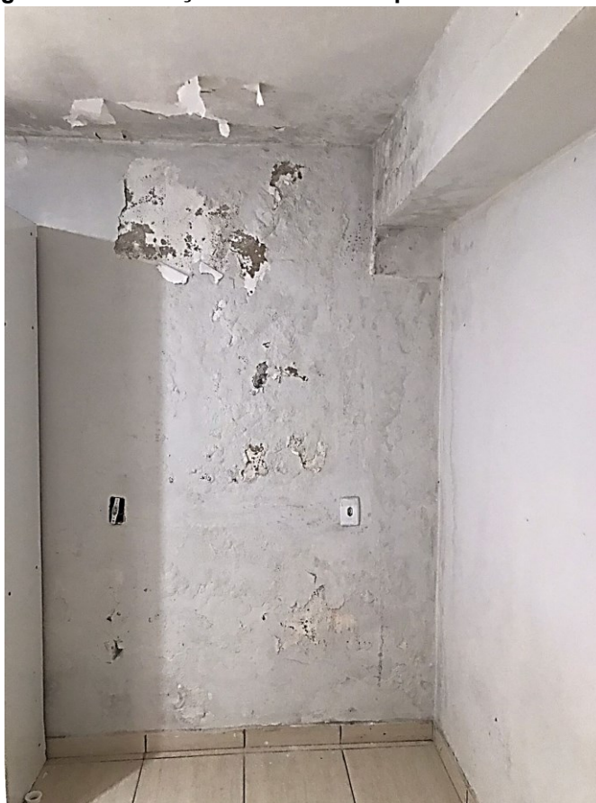
Fotografia 4 - Infiltrações ocasionadas pela cedência da calha.
