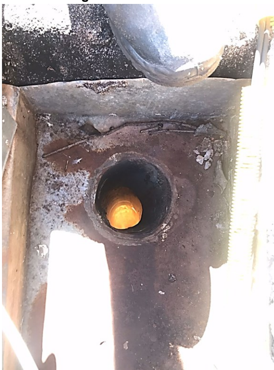
Fotografia 5 - Ralo da calha.
