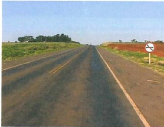
Figura 5 - Exsudação de asfalto
