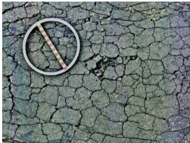
Figura 12 - Trinca interligada (couro de jacaré)
