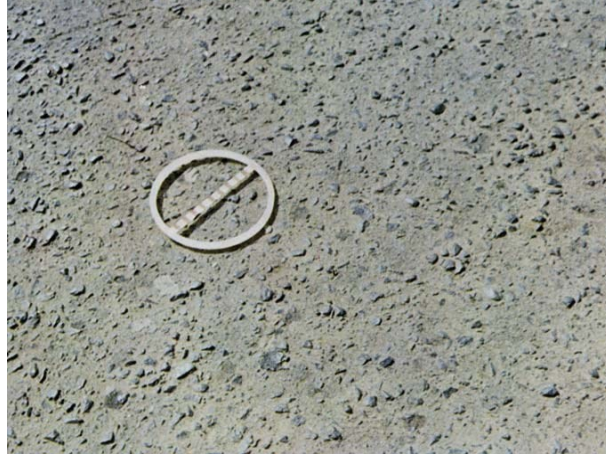
Figura 6 - Desgaste e desprendimento de agregado
