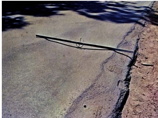
Figura 2 - Afundamento de trilha de roda
