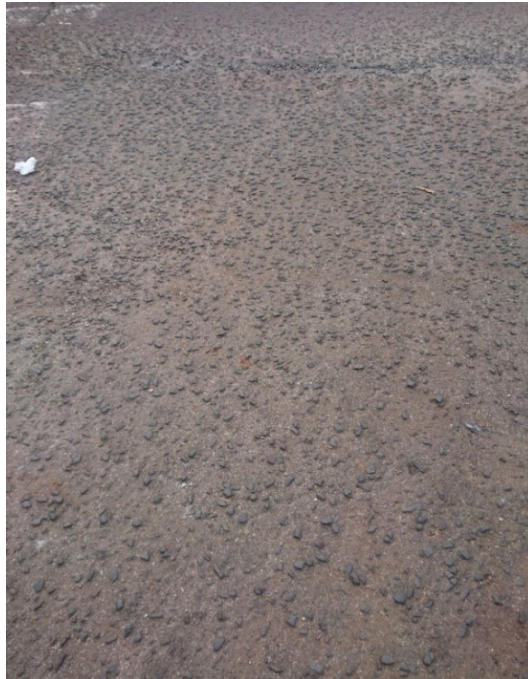
Fotografia 3 - Desgaste no trecho 7
