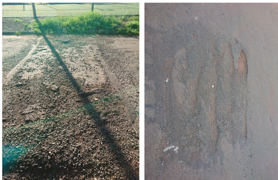
Fotografia 10 - Desprendimento (esquerda) e Remendo (direita), Rua João Xavier Padilha
