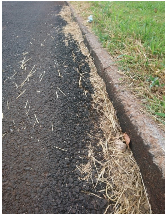
Fotografia 5 - Escorregamento betuminoso no trecho 10
