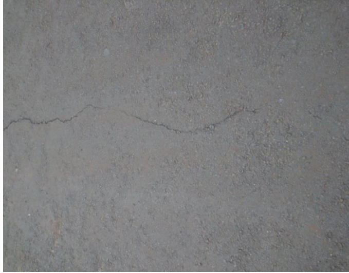
Fotografia 6 - Trinca transversal no trecho 7
