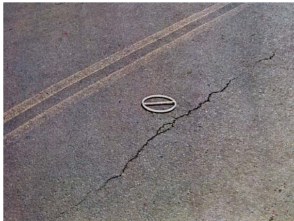
Figura 10 - Trinca isolada (longitudinal)
