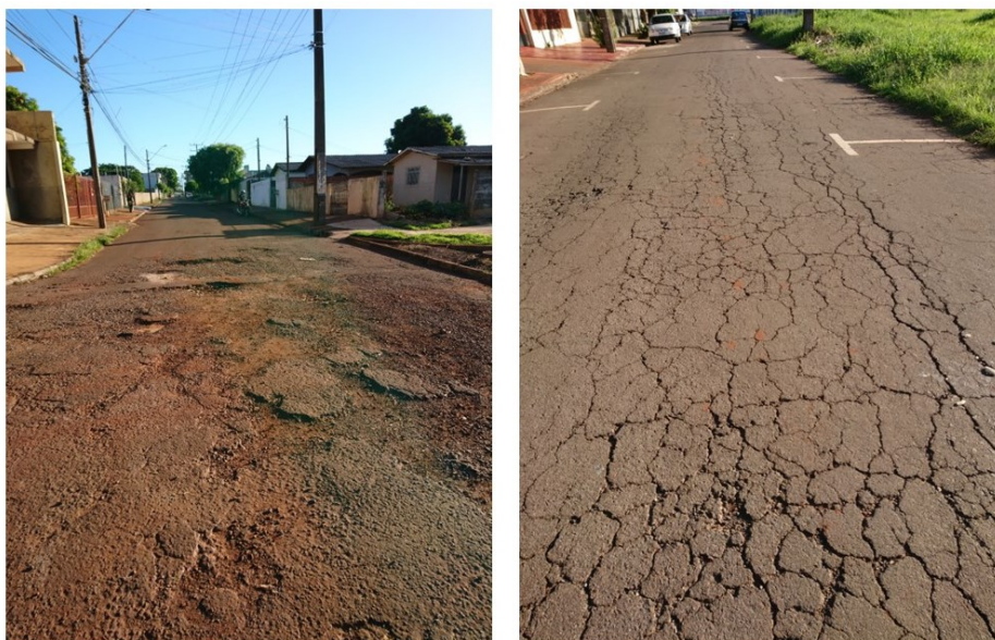
Fotografia 11 - Panelas (esquerda) e trincas (direita), Rua João Xavier Padilha
