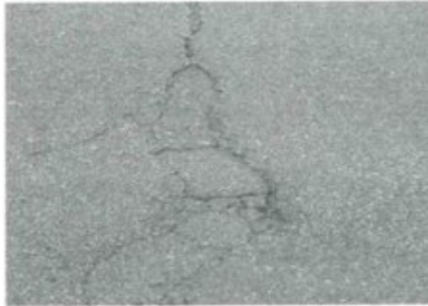
Figura 11 - Trinca isolada (retração)
