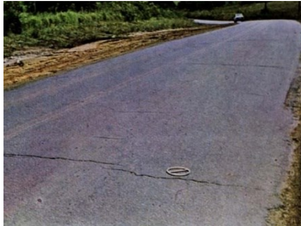
Figura 9 - Trinca isolada (transversal)
