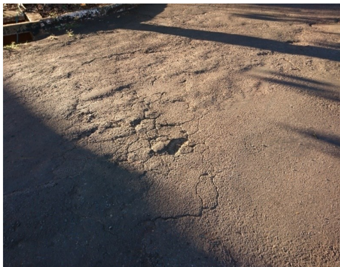
Fotografia 1 - Corrugação no trecho 13
