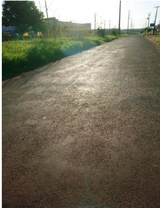
Fotografia 2 - Exsudação no trecho 9
