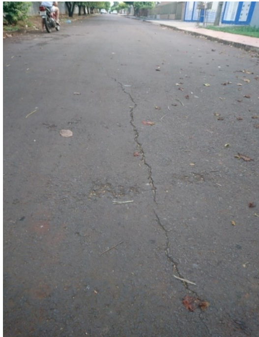
Fotografia 7 - Trinca longitudinal no trecho 5
