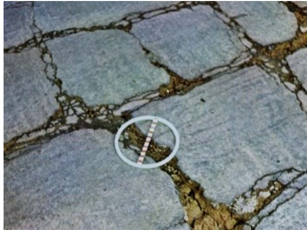
Figura 13 - Trinca interligada (tipo bloco)
