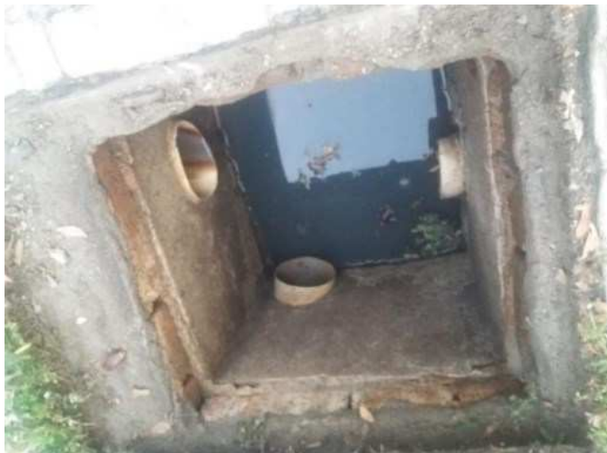
Figura 16 — Caixa de Gordura dimensionada incorretamente.
