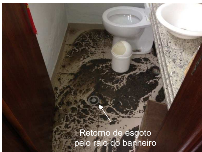
Figura 15 — Retorno de esgoto pelo ralo do banheiro.
