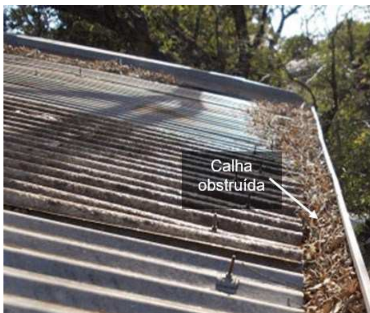
Figura 18 — Calha obstruída de telhado.
