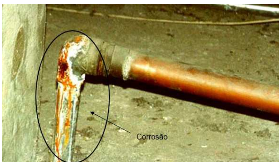
Figura 10 — Corrosão em tubulação de cobre.
