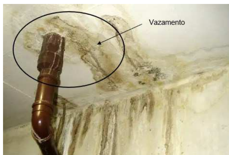
Figura 13 — Vazamento da instalação predial de esgoto sanitário.
