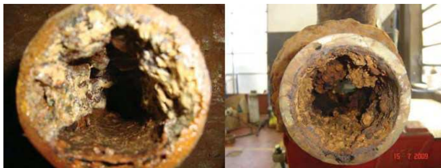
Figura 9 — Incrustações em tubulações.
