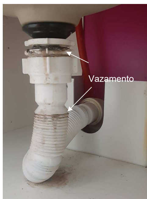
Figura 22 — Vazamento em sifão da pia.
