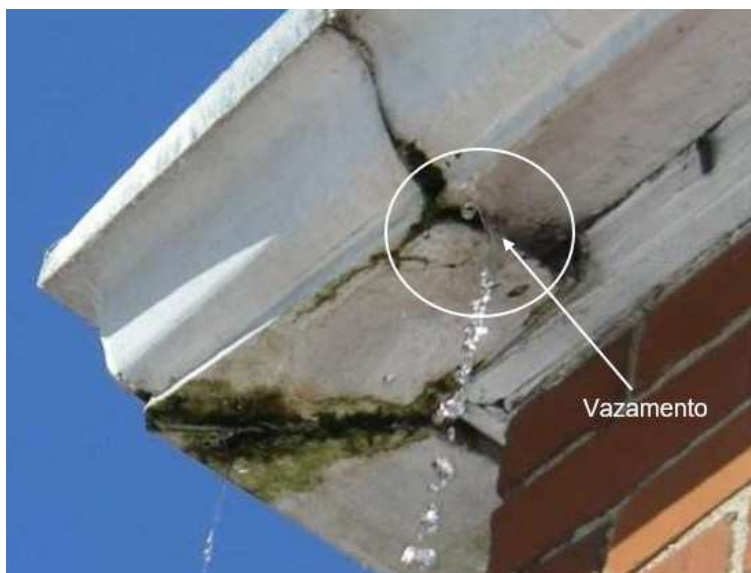
Figura 20 — Vazamentos em calhas de telhado.
