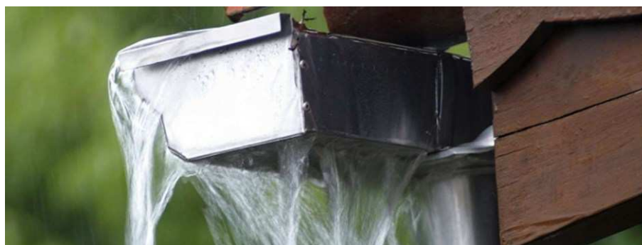
Figura 19 — Transbordamento de calha.
