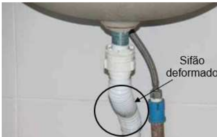
Figura 12 —Sifão deformado ocasionando mal cheiro no ambiente.
