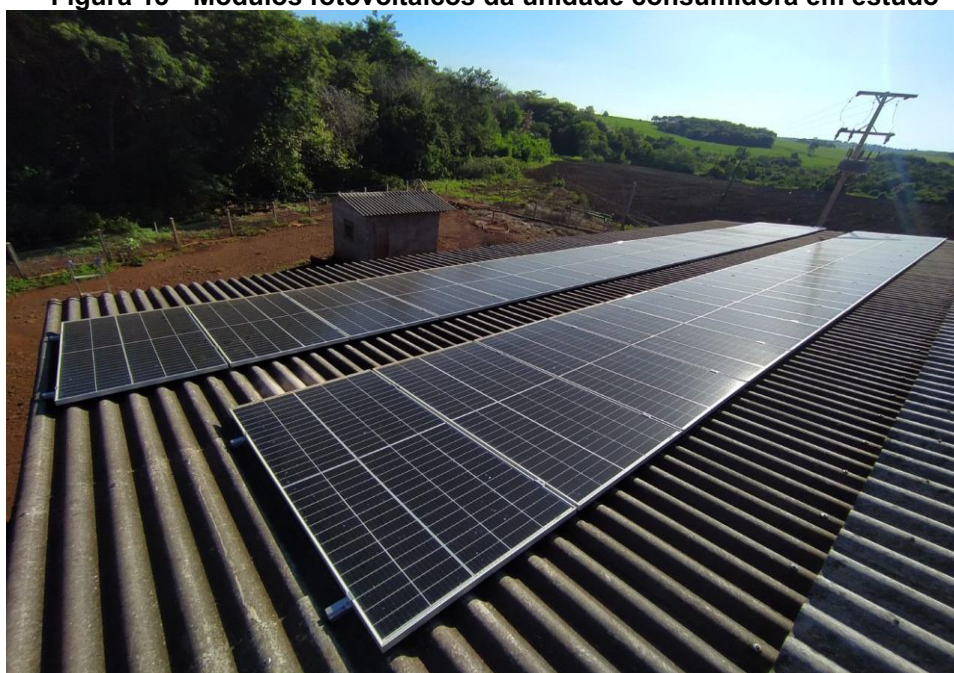
Figura 13 - Módulos fotovoltaicos da unidade consumidora em estudo
