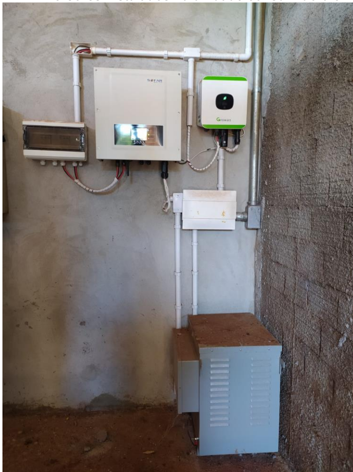
Figura 14 - Inversores instalados na unidade consumidora em estudo
