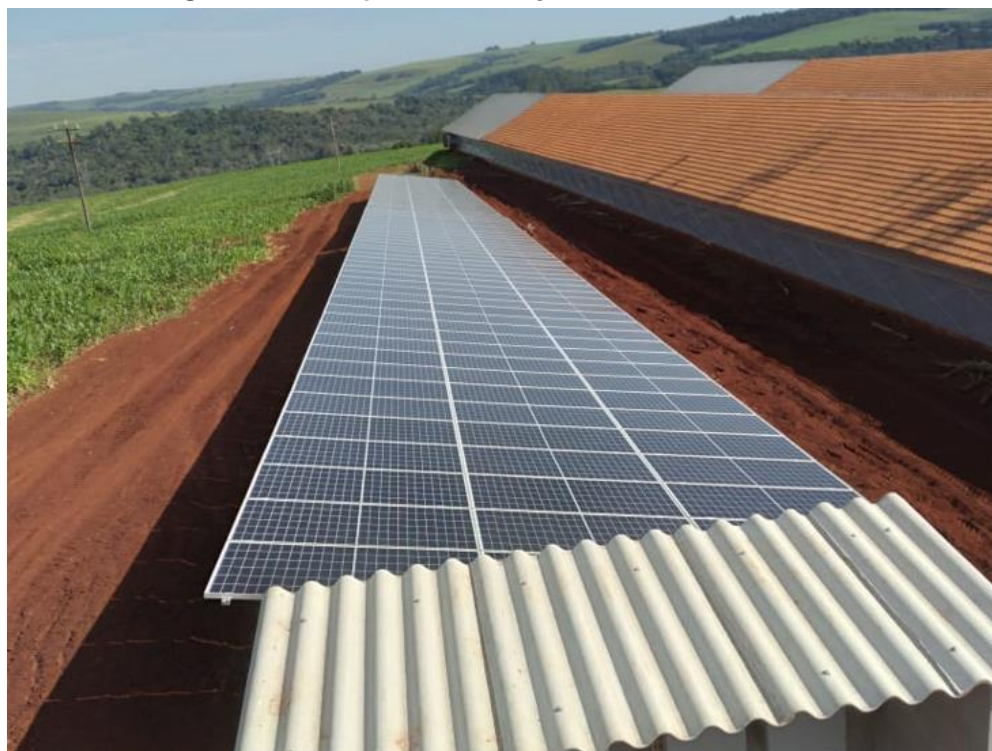
Figura 9 – Exemplo de instalação fotovoltaica em solo.
