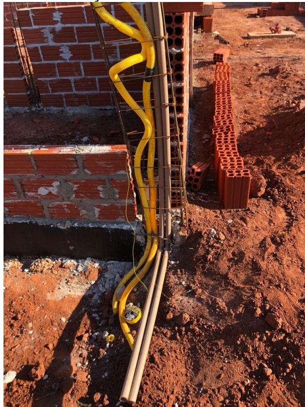
Fotografia 11 - Tubulação hidráulica e eletroduto dentro do pilar
