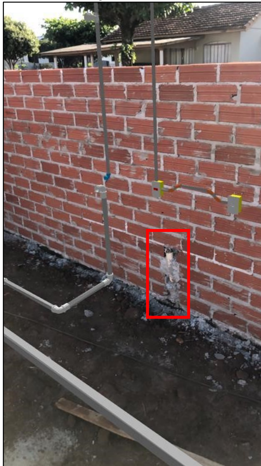
Fotografia 10 - Instalação hidrossanitário locada errada
