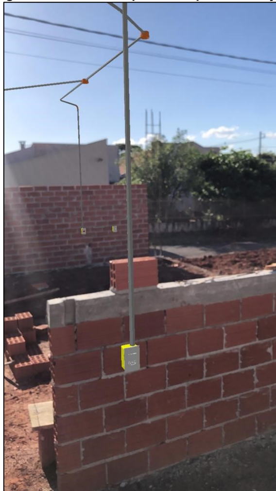
Fotografia 9 - Eletroduto passando pelo vão da janela
