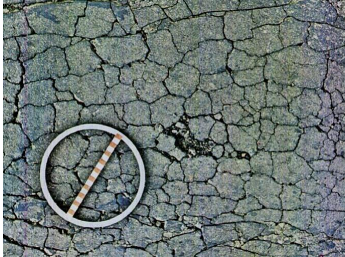
Figura 4 - Trinca tipo “couro de jacaré”
