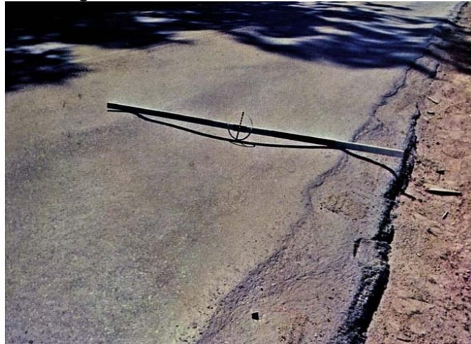
Figura 6 - Afundamento de trilha de roda.
