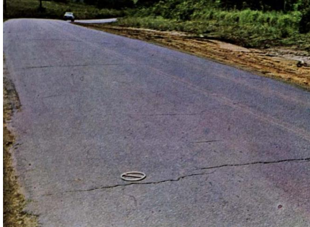
Figura 2 - Trinca isolada transversal
