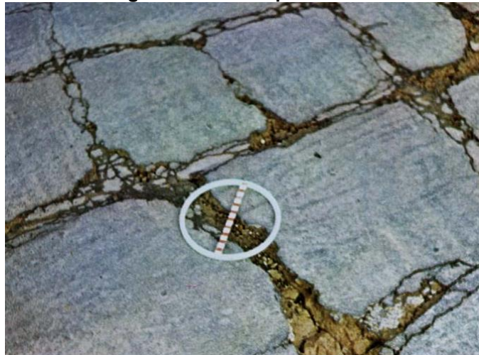
Figura 5 - Trinca tipo “Bloco”.
