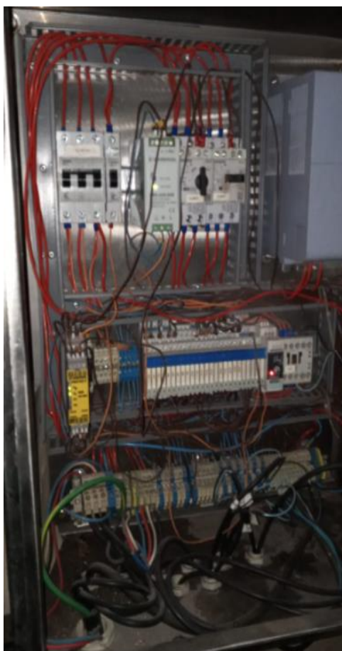
Fotografia 6 - Painel elétrico do sistema antigo
