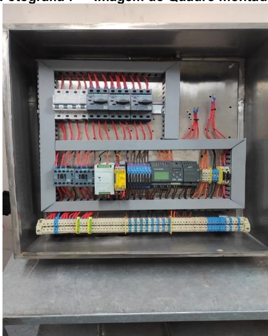
Fotografia 7 - Imagem do Quadro montado
