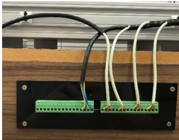
Figura 31 - Ligação entra a estrutura com seu hardware
