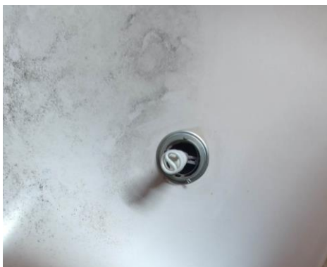
Figura 14 – Lâmpada fluorescente e luminária plafonier
