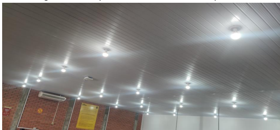
Figura 13 – Lâmpadas bulbo LED e luminária plafonier
