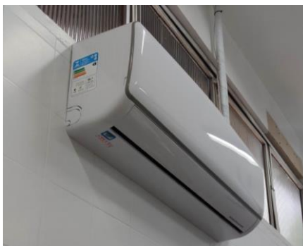
Figura 20 - Condicionador de ar do Cogeti
