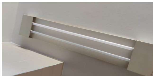
Figura 16 – Lâmpada tubular LED 1200 mm e luminária calha aberta
