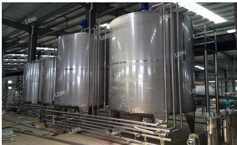
Figura 32 - Imagem ilustrativa dos tanques de armazenamento para o leite.
