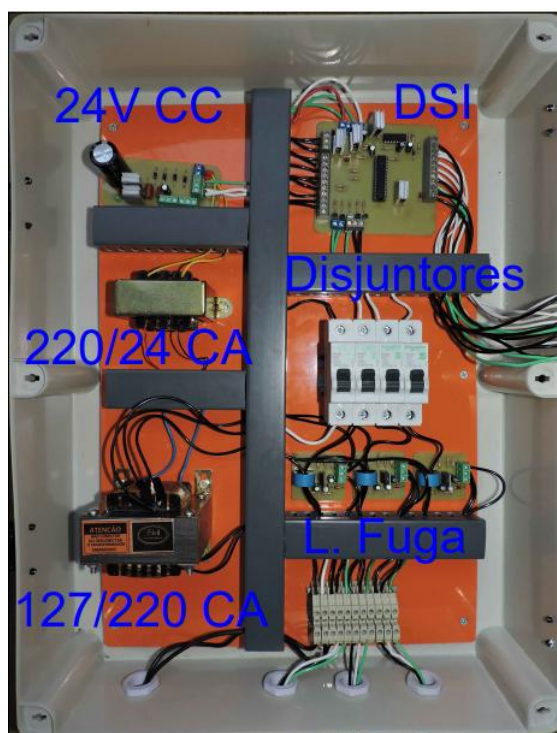
Figura 41 – Vista interna do quadro para um sistema IT-Médico.png
