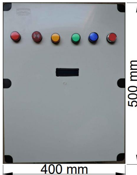
Figura 40 – Vista externa do quadro para um sistema IT-Médico.
