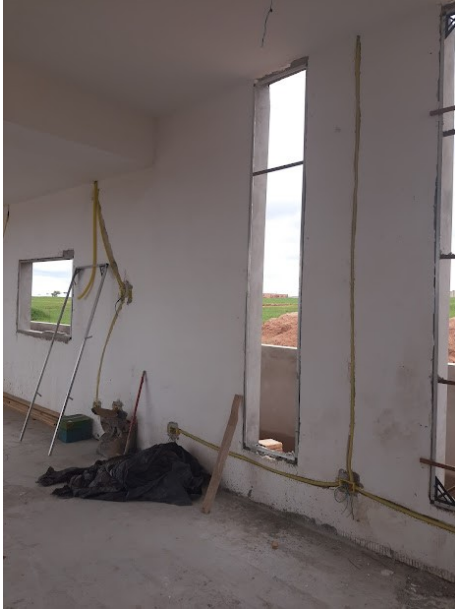
Figura 27a - Instalações Elétricas Obra A.
