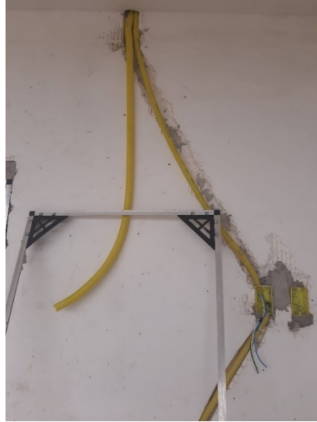
Figura 27b - Instalações Elétricas Obra A.
