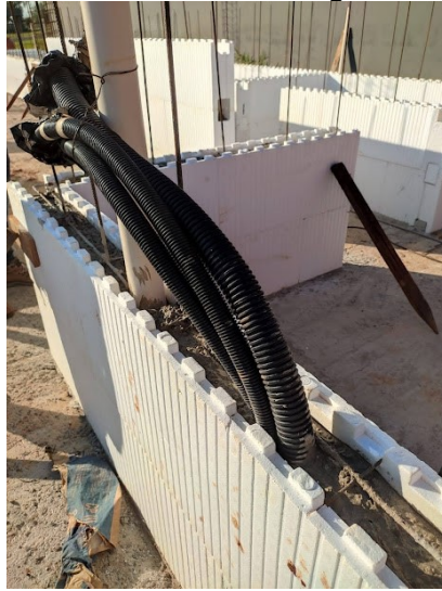
Figura 26 - Eletroduto corrugado Obra C.
