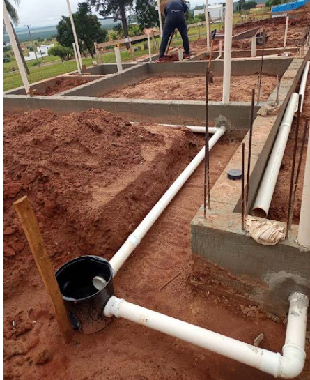
Figura 10a - Tubulação de esgoto.
