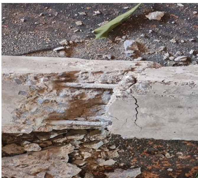
Figura 34: Armadura positiva da viga rompida (adesivo estrutural).
