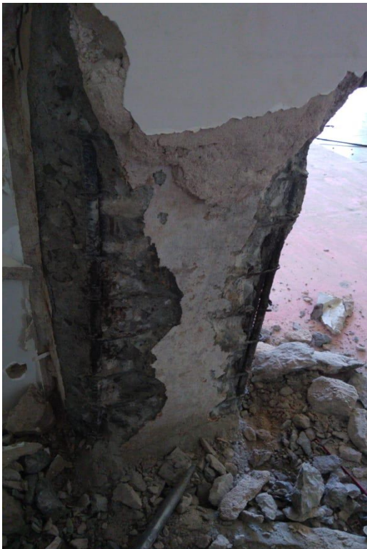
Figura 9: Pilar com carbonatação do concreto.
