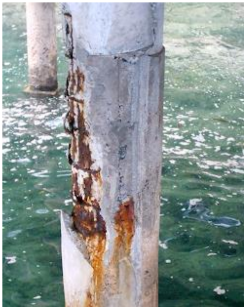
Figura 6: Pilar com corrosão devido ao ataque de cloretos.
