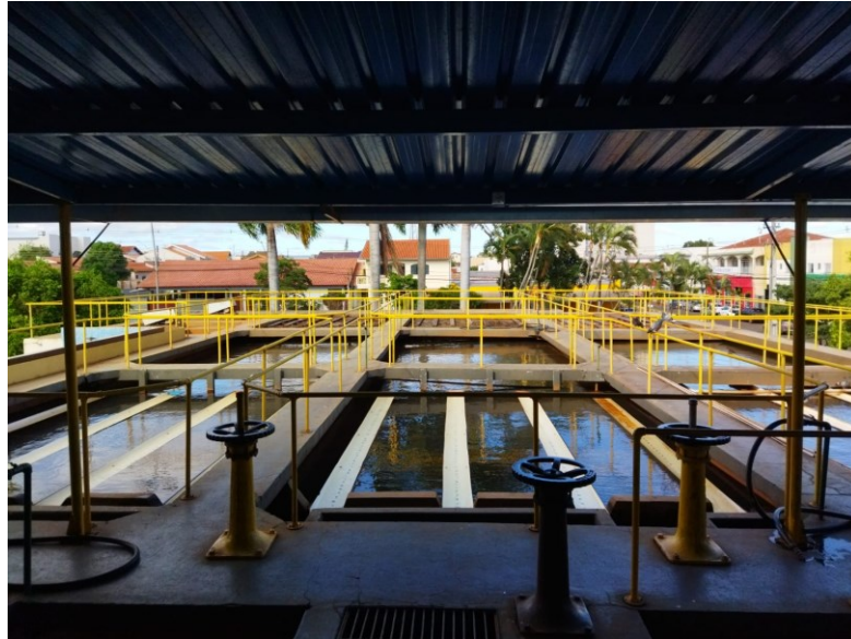
Figura 6 - Decantadores da ETA da SAMAE - Ibiporã.
