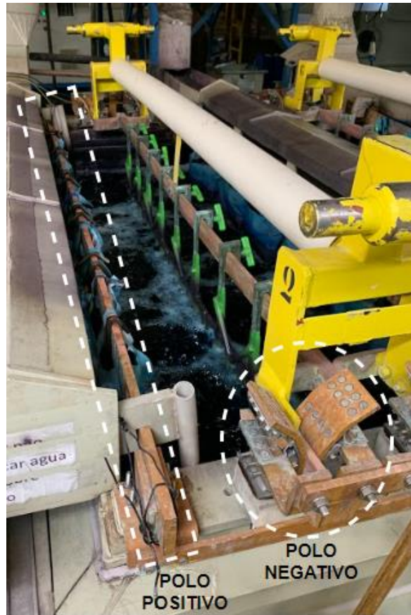
Figura 3: Barramento de linha automática de galvanoplastia.
