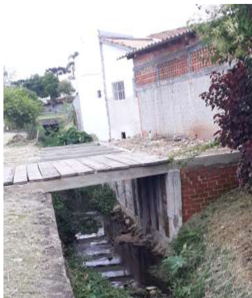
Figura 18 - Assentamentos irregulares nas margens do rio dos Padilhas Fonte: Aatoria própria, 2021.
