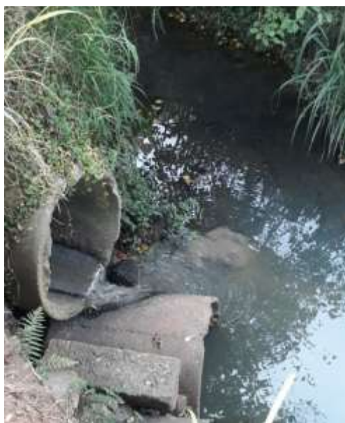
Figura 19 – Lançamento de esgoto no rio Padilha. Fonte: Autoria própria (2019).
