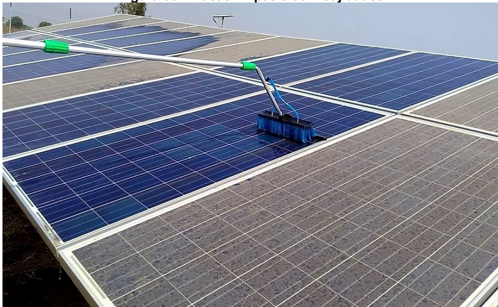
Figura 08 –Placas limpas e com sujidades
