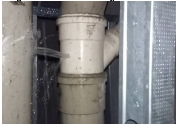
Figura 9 – Prumada de Esgoto Danificada
