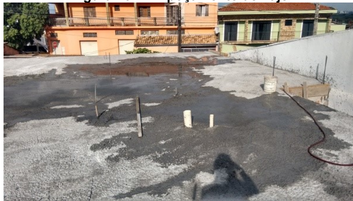
Figura 16 – Empoçamento de Laje
