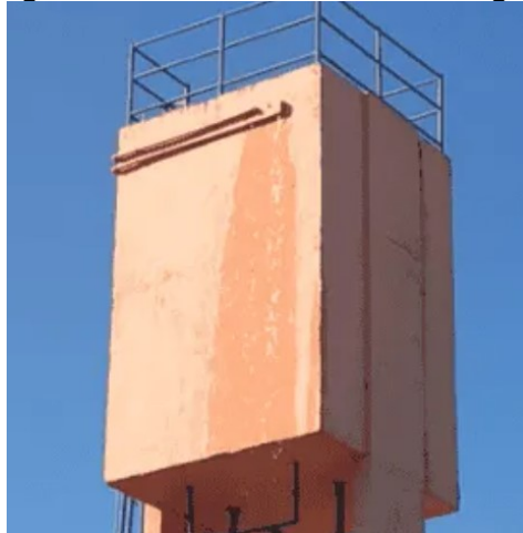
Figura 7 – Vazamento em Caixa D'água
