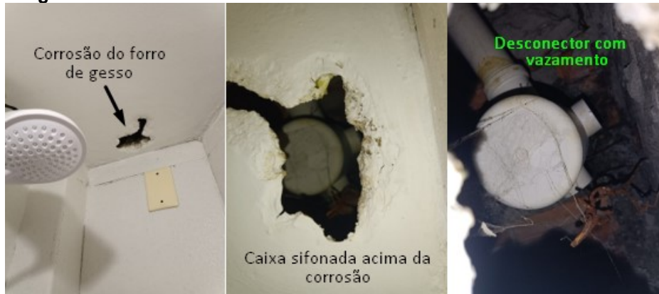
Fotografia 1 – Vazamento na Caixa Sifonada e Corrosão do Forro de Gesso
