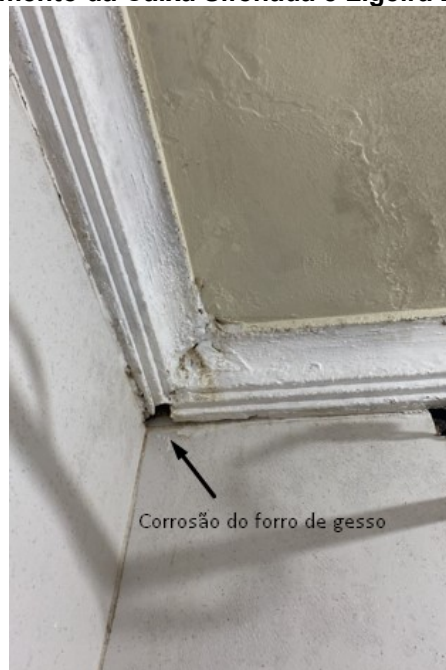
Fotografia 2 – Vazamento da Caixa Sifonada e Ligeira Degradação do Forro
