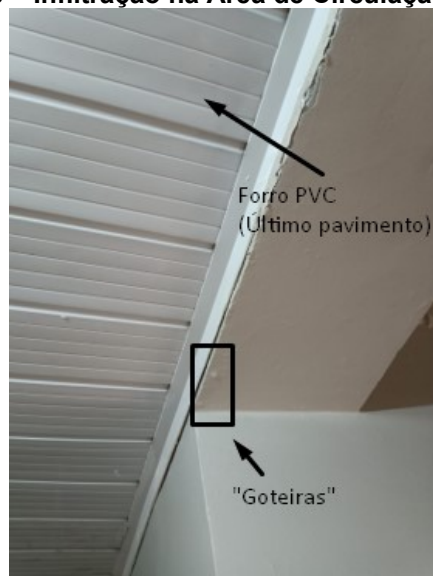
Fotografia 8 – Infiltração na Área de Circulação de Pessoas
