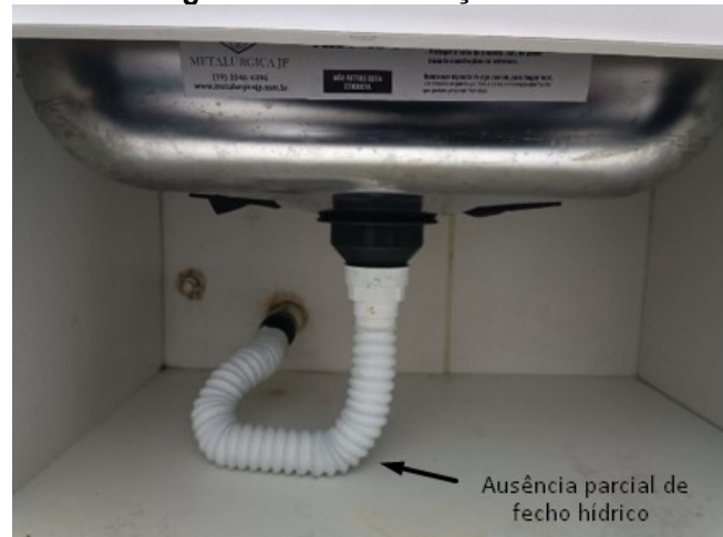
Fotografia 4 - Má Instalação de Sifão
