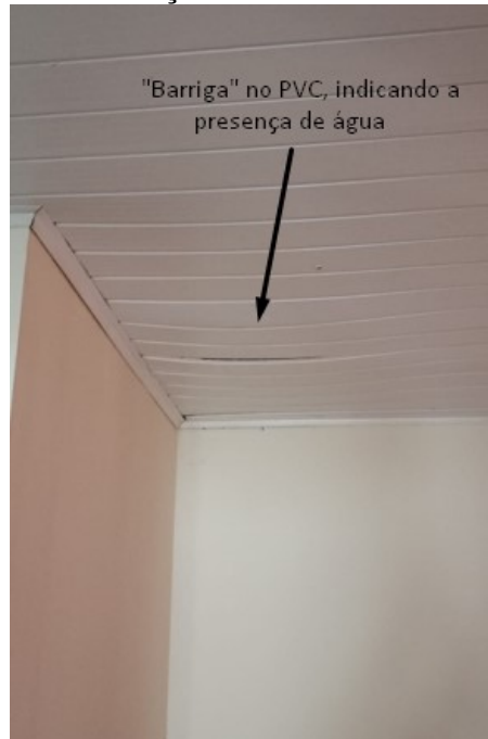
Fotografia 7 – Infiltração em uma Unidade Habitacional
