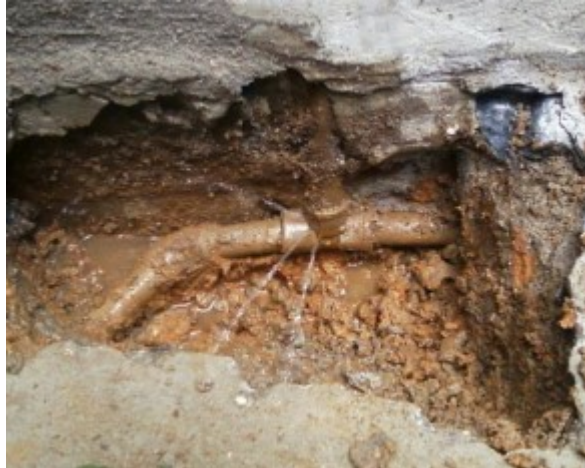
Figura 6 – Vazamento em Canalização Enterrada
