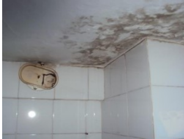
Figura 14 – Infiltração de Água pela Cobertura
