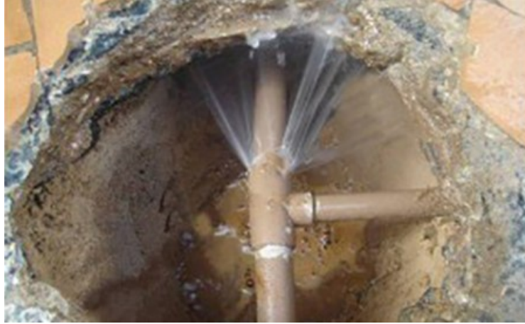
Figura 8 – Ruptura de Canalização por Excesso de Pressão
