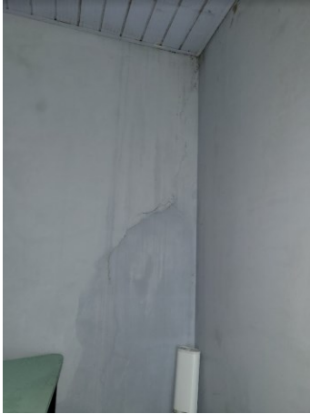
Figura 53 – Manchas (Fi=2) e fissuras (Fi=1)
