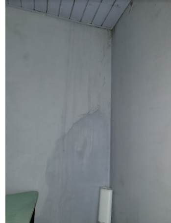
Figura 38 – Fissura (Fi=1) e manchas (Fi=2)
