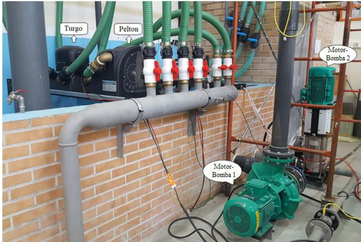
Figura 39 – Sistema hídrico com turbinas Turgo e Pelton, Motor 1 (Q3E PA 132M4B-93 N) e Motor 2 (Q3E FA 132M2C-40 H).
